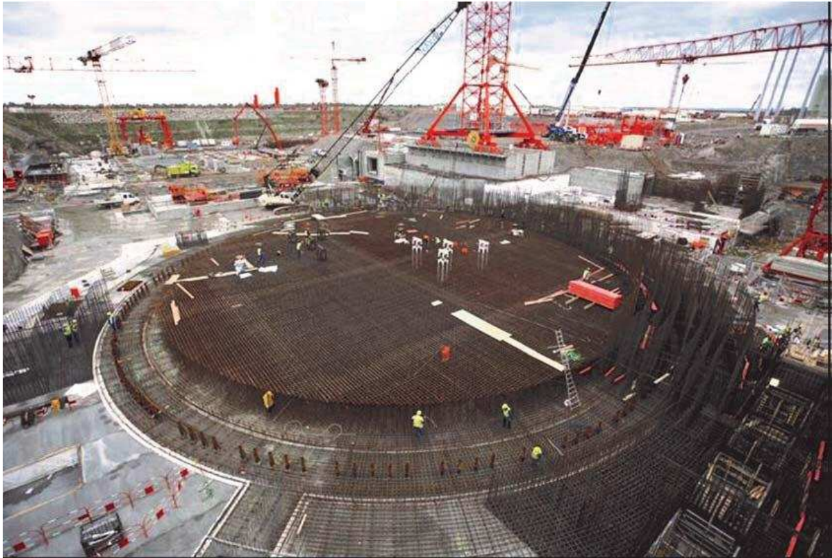
Le chantier EPR à Flamanville en décembre 2007 (source : EDF dossier presse EPR Décembre 2007)
